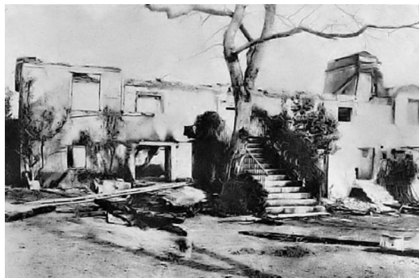
Fig. 6 – Imagem da ruína da Casa de Camilo após um devastador incêndio em 1916; http://noitesdeinsonias.blogspot.com/2010/01/incendio-na-casa-de-camilo-castelo.html
