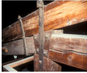
a) Pormenor da estrutura do telhado de madeira, Salone dei Cinquecento, Palazzo Vecchio, Florença, Itália [25]
