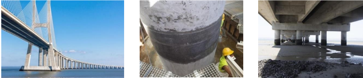
Figura 2.34 - Reforço dos pilares da Ponte Vasco da Gama com mantas de CFRP (S&P Clever Reinforcement Ibérica, 2017 [48]).
