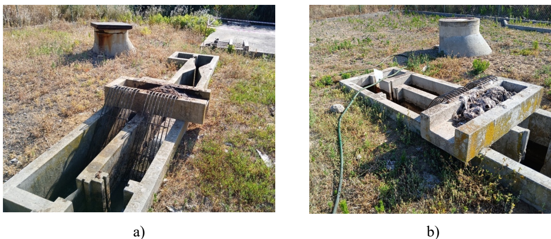
Figura 12 - Obra de Entrada da ETAR a) de Lousal Norte b) e de Sul (Hidrofunção – Consultores de Engenharia, Lda).
