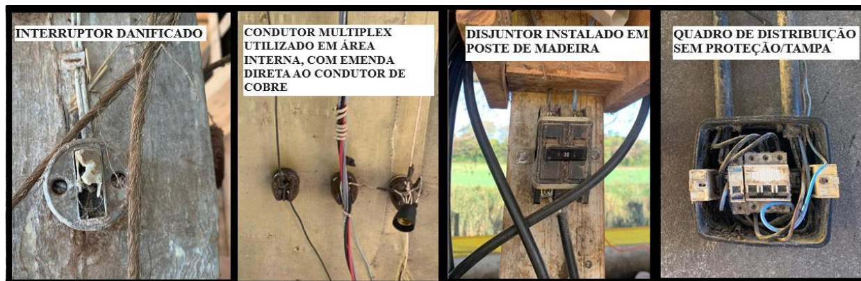
Figura 2. Instalações elétricas verificadas durante a pesquisa (Próprio autor, 2024).
