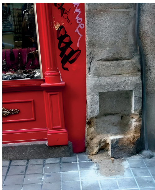
Fig. 8. Destruição da base de uma pilastra com a instalação de caixas de redes. Fonte: Foto dos autores
