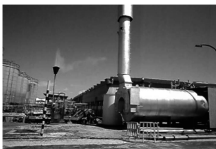
Figura 2 – Gerador a vapor
