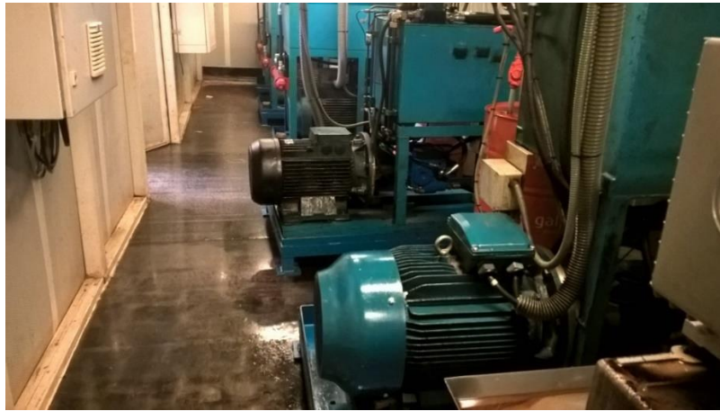
Figura 3-10: Central do circuito hidráulico
