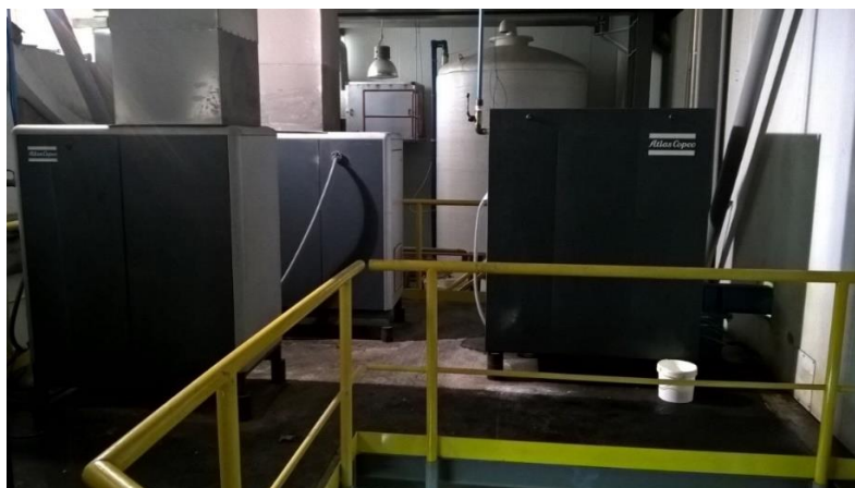
Figura 3-14: Central de ar comprimido
