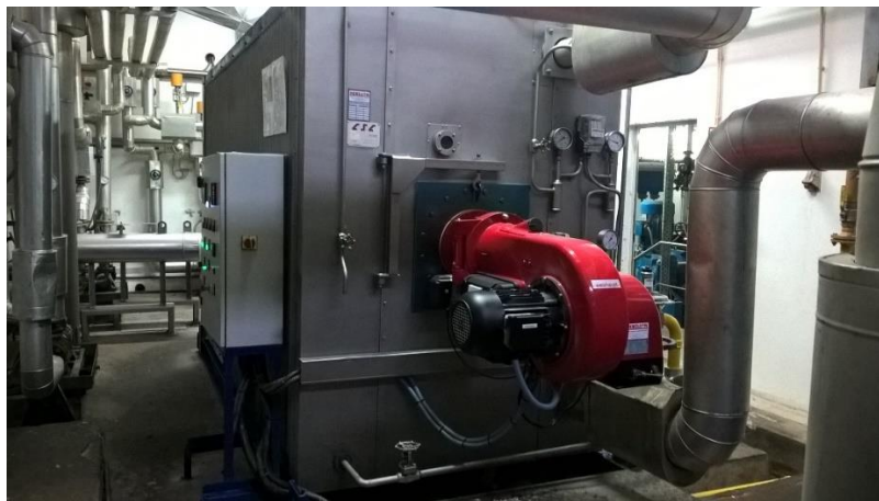
Figura 3-11: Caldeira e respetivo queimador do circuito de termofluido
