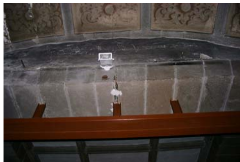
Figura 6 – Pormenor da abertura de fendas
