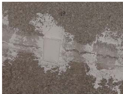
Figura 8 – Pormenor da abertura de fendas em A_{p1}
