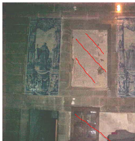
Figura 10 – Padrão de fendilhação da parede sobre o arco A_{s1}
