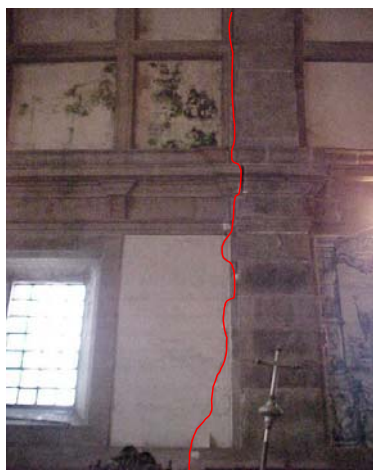
Figura 9 – Vista da parede danificada com identificação de fissura (a vermelho)
