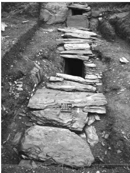
Figura 12 – Capeamento da Galeria da Quinta da Ivanta
