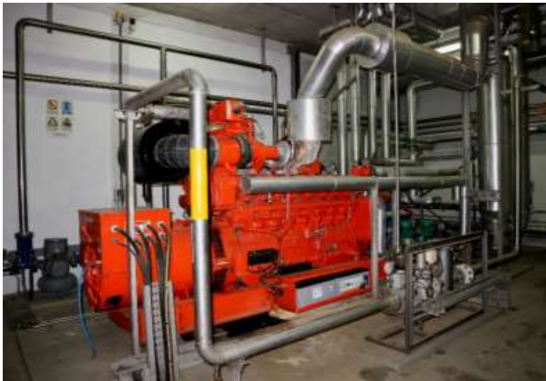
Figura 16: Grupo de cogeração.
