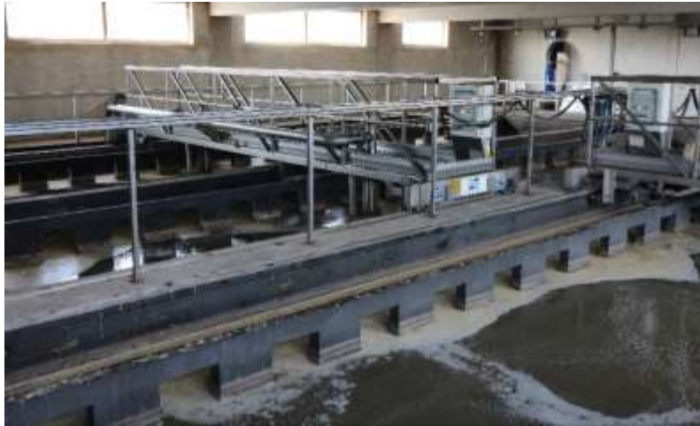
Figura 12: Etapa de desarenamento e desengorduramento
