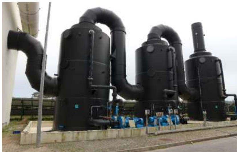
Figura 17: Sistema de desodorização.
