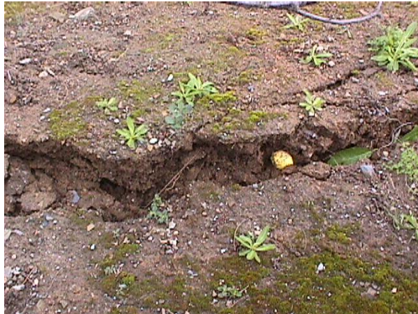
Fenda na encosta abaixo da estrada
