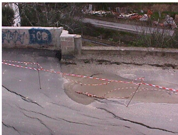
Fendas no asfalto
