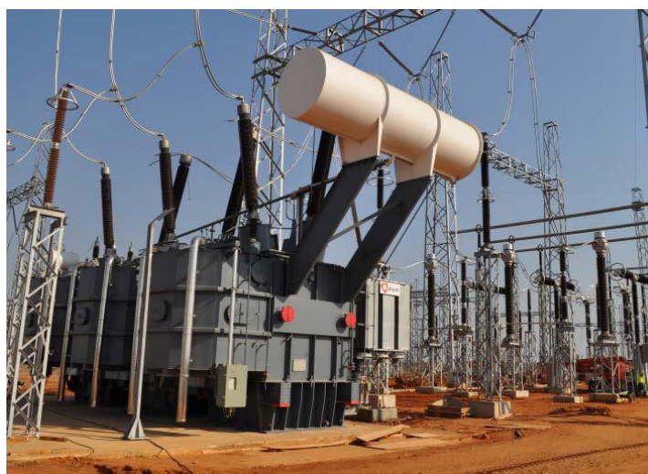
Figura 4.2 Transformador de potência 400 MVA (Efacec, 2012)
