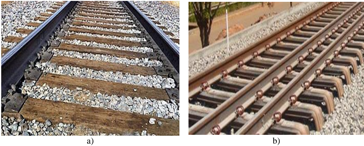
Fig. 6 – Via balastrada assente em travessas de diferentes composições: a) travessas em madeira (cobblumber, 2023); b) travessas metálicas (Hidremec s.d., 2023)
