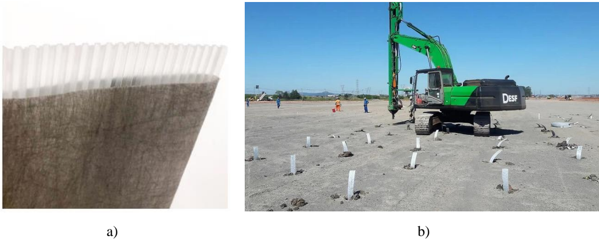
Fig. 23 – Instalação de geodrenos: a) pormenor de um dreno pré-fabricado (American Wick Drain, 2023); b) vista geral (GeoSoluções, 2023)
