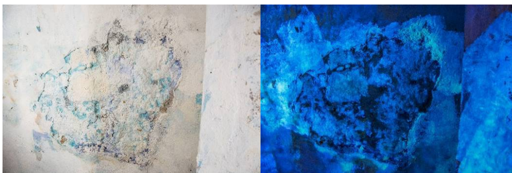
Figura 6. Zona de lacuna de revestimento de uma parede em alvenaria. Luz visível (6A) e imagem de fluorescência UV (6B), na qual as áreas que se apresentam com fluorescência esverdeada correspondem a zonas de efluorescência de sais ou de ataque biológico da camada de revestimento, não detectáveis na imagem 6A.
