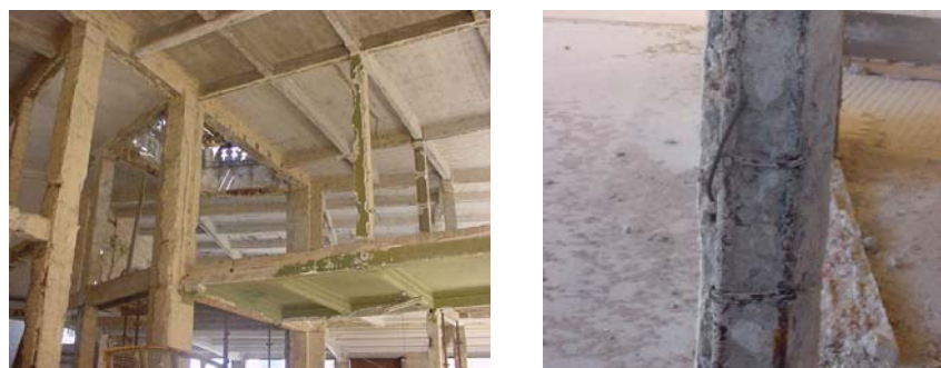
Figura 7. Estrutura de betão armado “despida” dos elementos decorativos interiores; exposição das armaduras ao meio ambiente exterior
