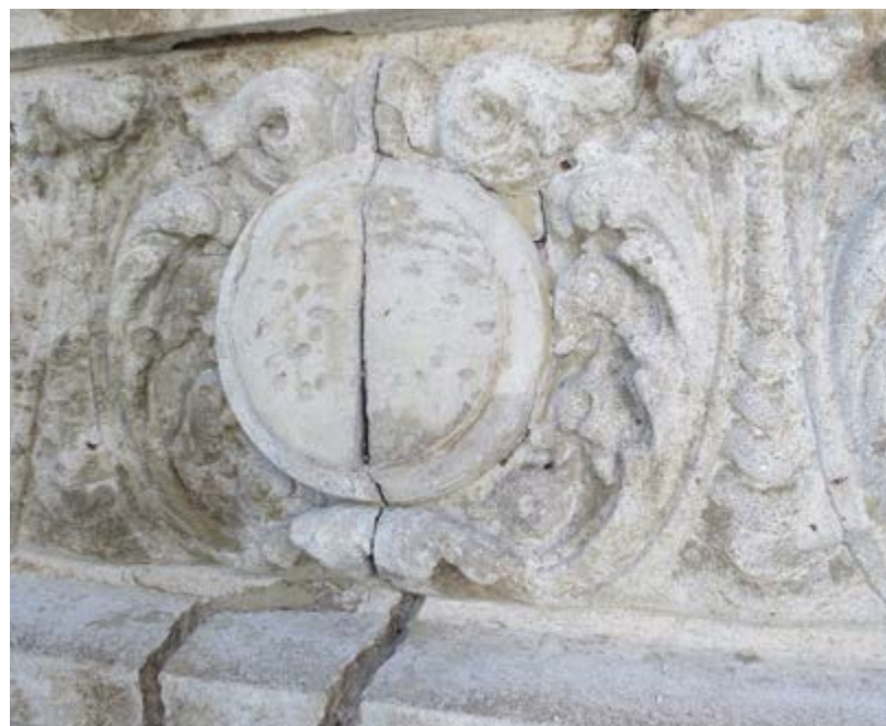
Figura 80 – Junta vertical a eixo da “bolacha”. No entanto, foram encontradas “bolachas” sem esta junta, 2013.
