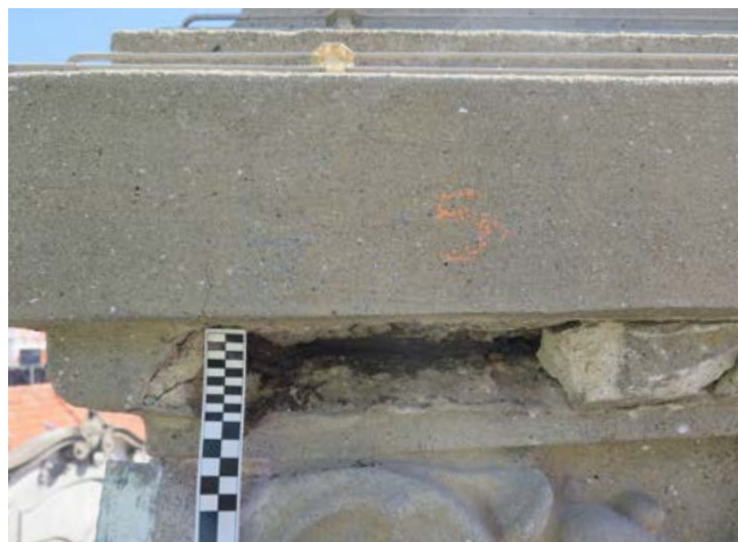
Figura I03 – Pormenor da corrosão dos varões longitudinais, 2017.
