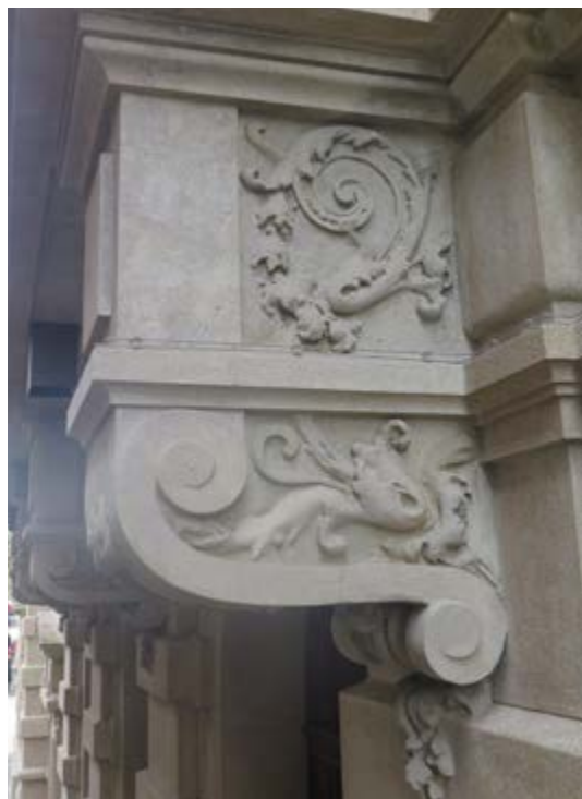
Figura 75 – Vigas cachorro de varandas, 2017.
