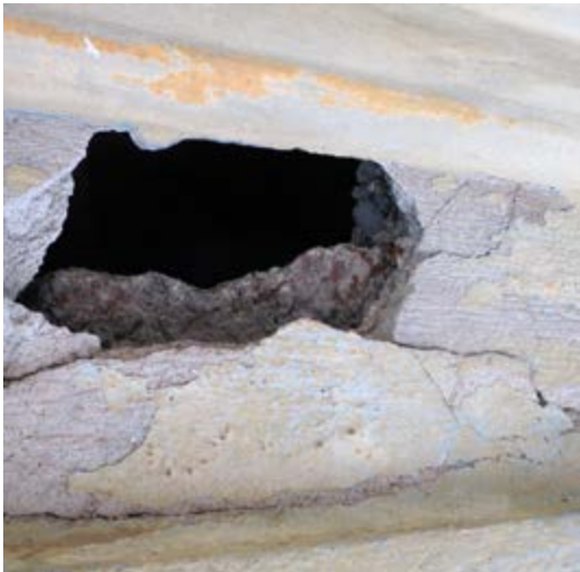
Figura 93 – Corrosão da rede de galinheiro, 2013.
