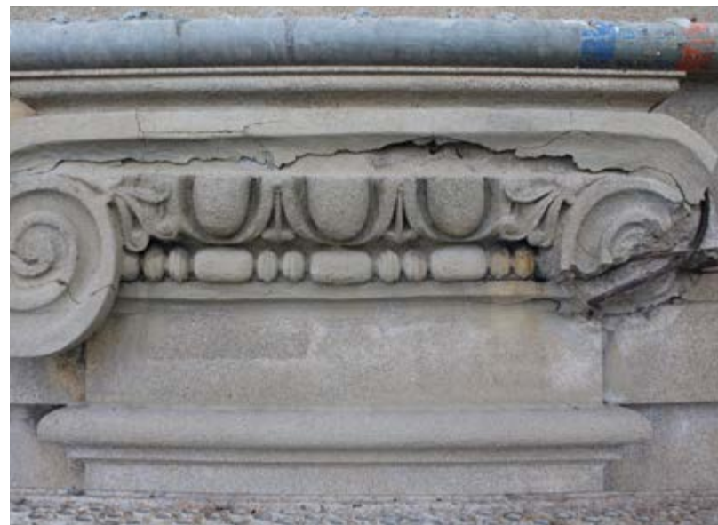
Figura 51 - Degradação de voluta, 2013.
