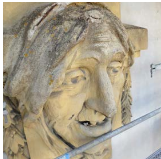
Figura 162 - Varões metálicos na zona da cabeça, 2013.
