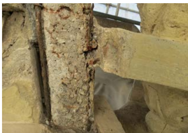
Figura 6 – Pilar de apoio do vaso, 2014.
