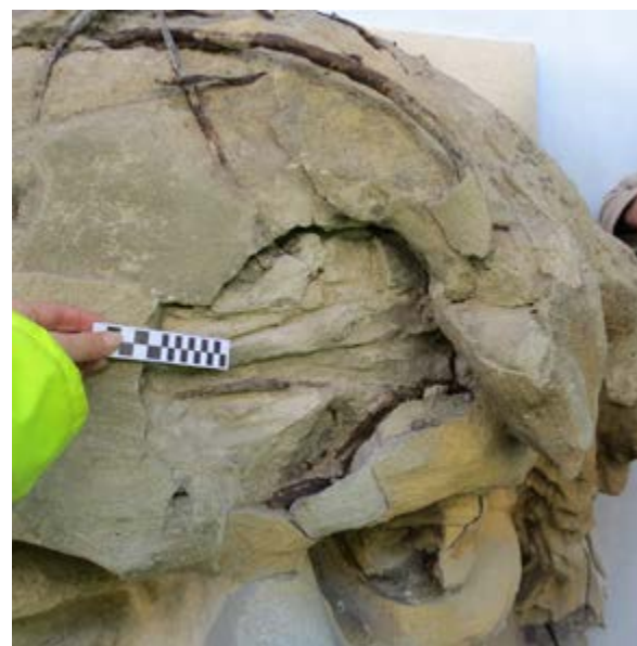
Figura 48 – “Carranca de teste” na fachada poente, 2013.
