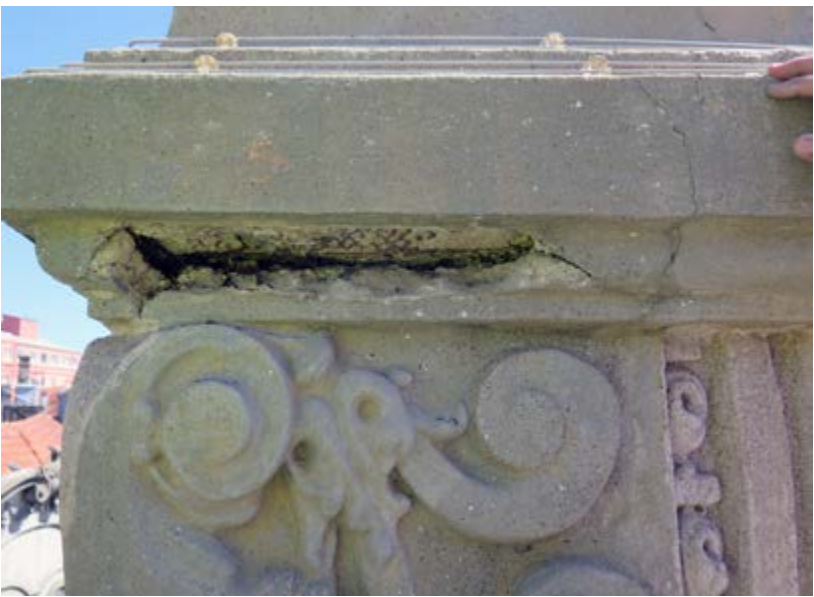
Figura 34 – Murete do topo da fachada poente, em volume oco, com varão e rede de galinheiro, 2017.
