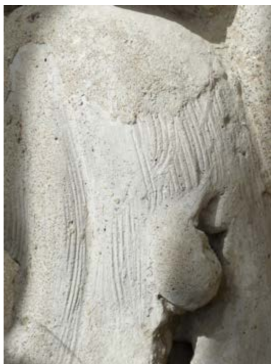
Figura 24 – Rasuras e emborro de proteção sobre elemento decorativo, 2014.
