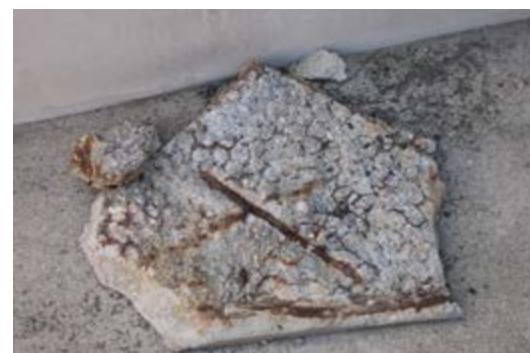
Figura 62 – Fragmento de betão destacado por corrosão de armaduras (sendo visíveis varões e rede de galinheiro), 2013.
