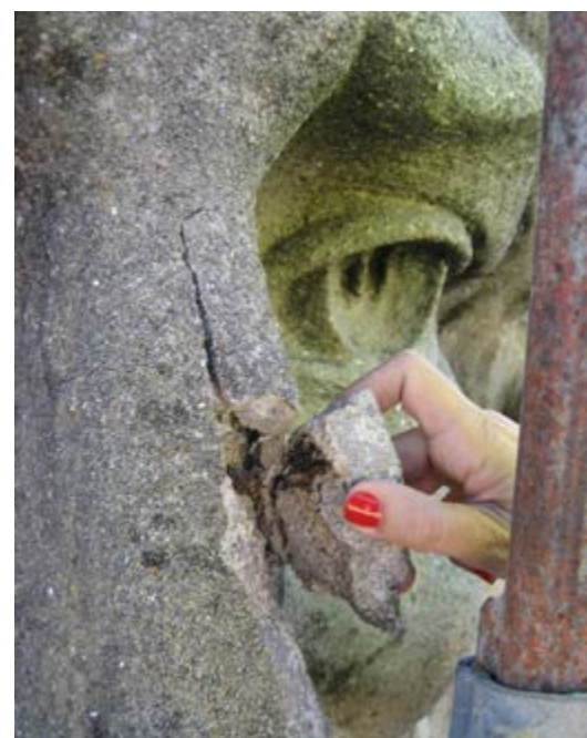
Figura 61 – Destacamento de argamassa por corrosão de armaduras, 2010.
