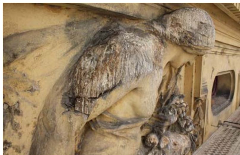
Figura 57 – Fissuração e destacamento de argamassa em estátua, por corrosão dos varões metálicos, 2010.
