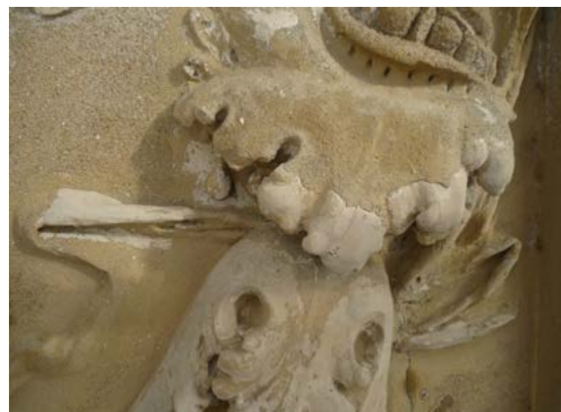
Figura 25 – Embarro sobre elementos decorativos da fachada sul, 2014.
