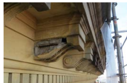
Figura 29 – Varões metálicos nas mísulas, 2013.
