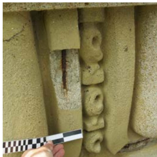
Figura 58 – Fissuração e destacamento de argamassa por corrosão dos varões metálicos em friso decorativo, 2013.
