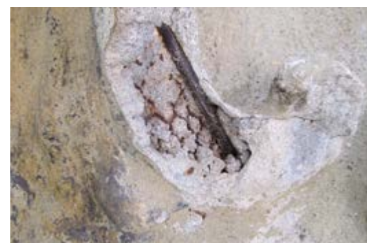
Figura 27 – Varão metálico e rede de galinheiro na ligação à fachada, 2013.
