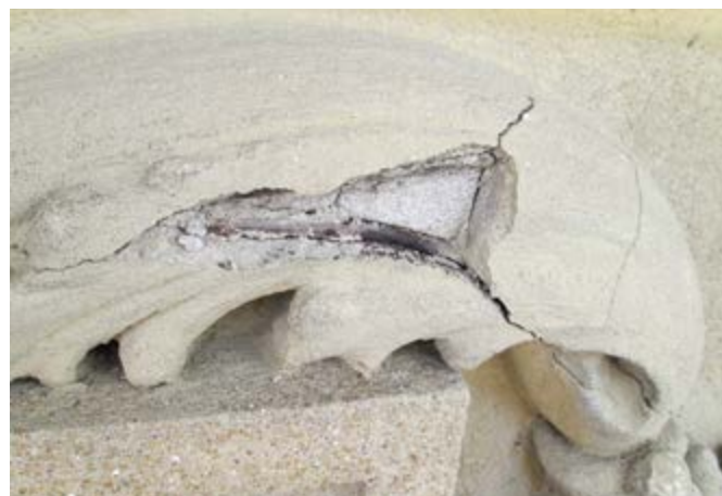
Figura 59 – Fissuração e destacamento de argamassa por corrosão de armaduras, 2014.
