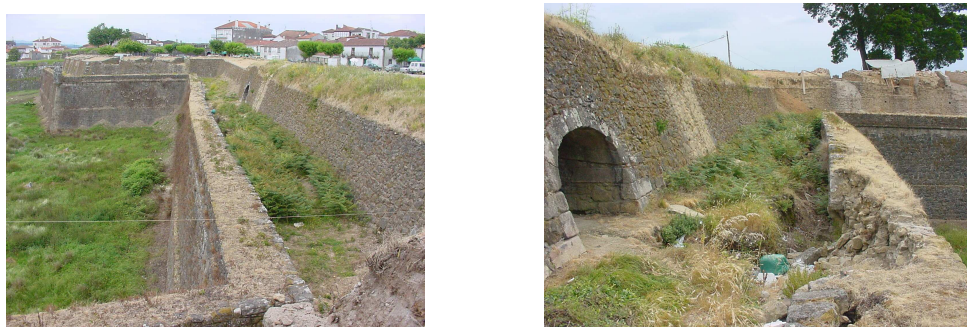
Figura 3 – Danos observados na muralha de Valença
