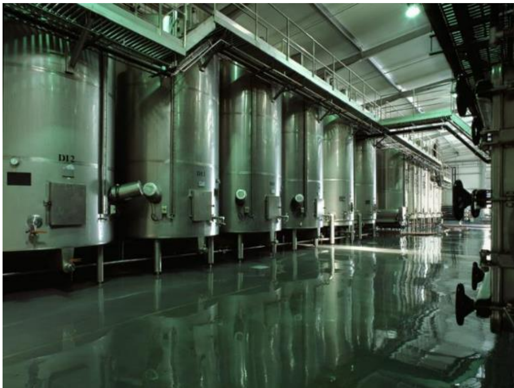
Figura 19 - Zona de armazenagem e estabilização de vinhos, da Falua SA.
