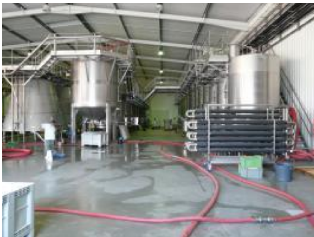
Figura 17 - Zona de vinificação e estabilização de vinhos, da Falua SA.
