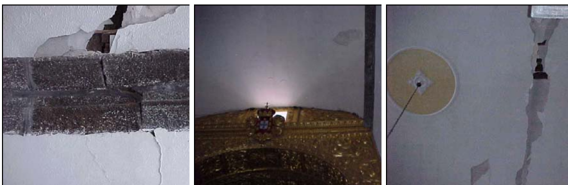
a) Fendilhação na zona do coro alto
