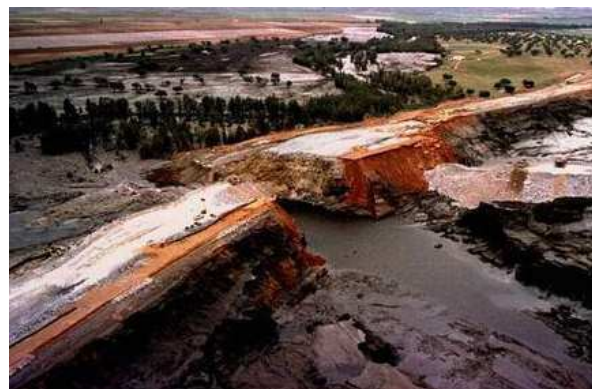
Barragem de lamas de Aznalcóllar colapsada (Espanha) - 1998
