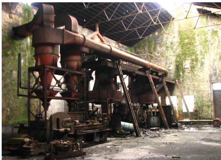
Foto 11: edifício da Fundição: pormenor dos dois fornos e sistema de extração de fumos (nave central).
